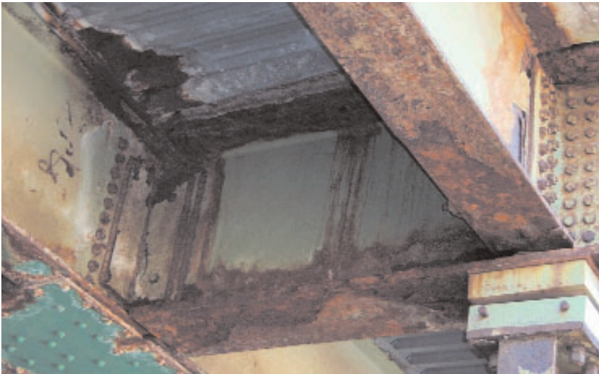
Corrosión del acero estructural.
