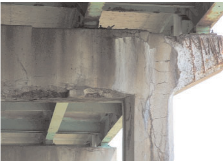
Corrosión con spalling.
