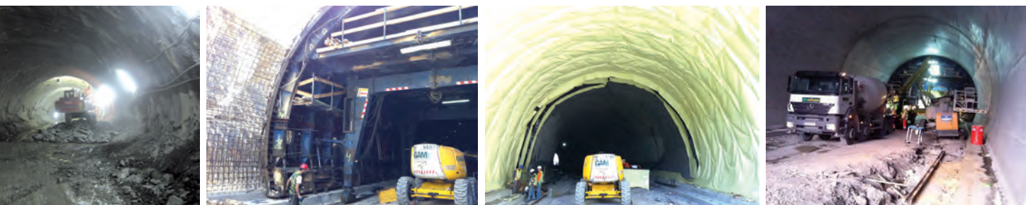
túnel, que con una longitud de 284 m, atraviesa el núcleo urbano de Santullán
