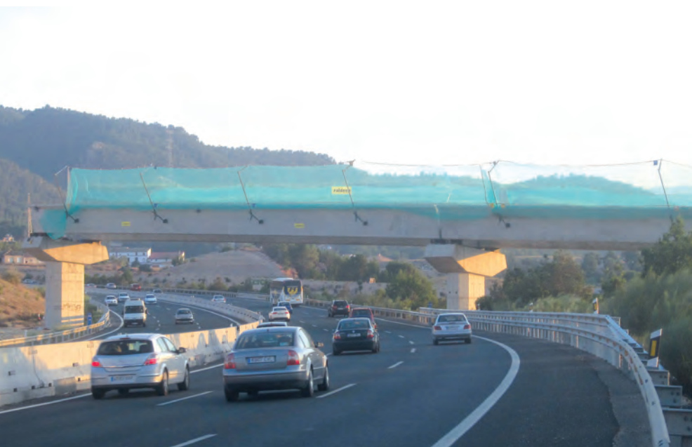
Estructura E-2 que permite el paso de la calzada derecha de la autovía MU-31, en sentido a Murcia, sobre la autovía A-30 y la rambla del Puerto
