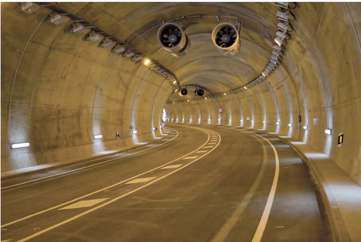
Vista interior del túnel dotado de todas las medidas de seguridad que exige tanto la normativa comunitaria como la española
