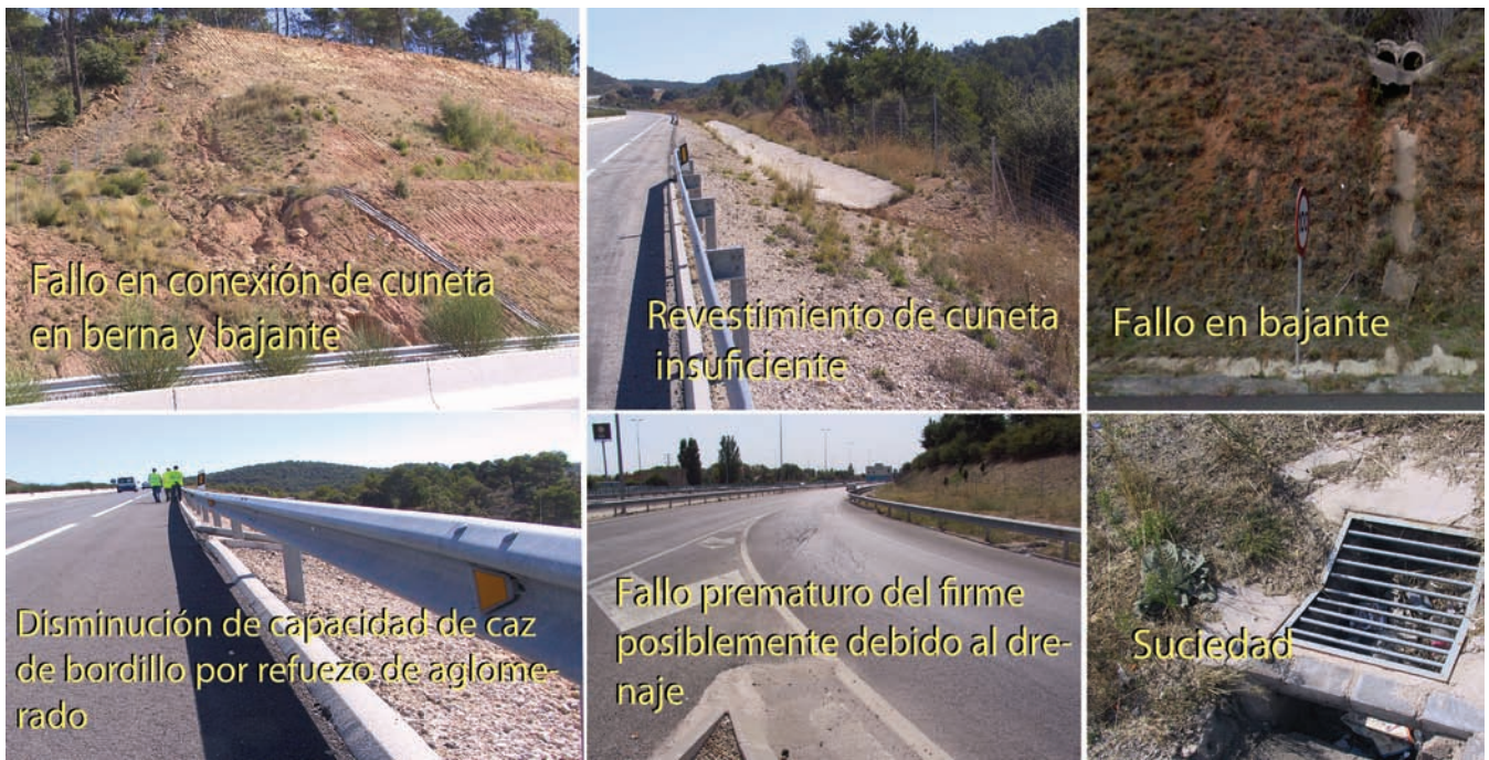
Figura 1: Detalles de fallos relativamente frecuentes en el drenaje de la plataforma y márgenes.
