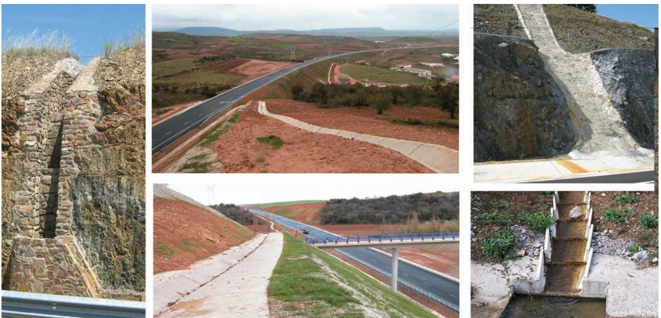
Figura 2: Detalles de construcción cuidadosa en el drenaje de la plataforma y márgenes.
