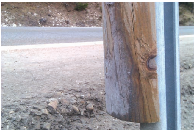
Figura 8. Detalle de la degradación de la madera por efecto de la humedad en un poste de fijación de barrera de seguridad de madera.
