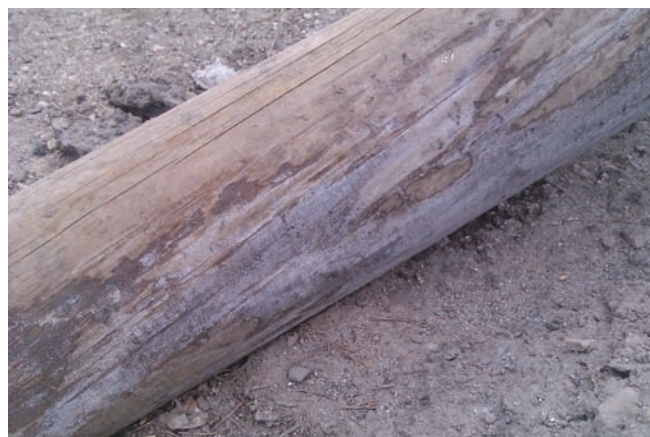
Figura 9. Detalle de la degradación de la madera por efecto de la humedad en perfil longitudinal de barrera de seguridad de madera.
