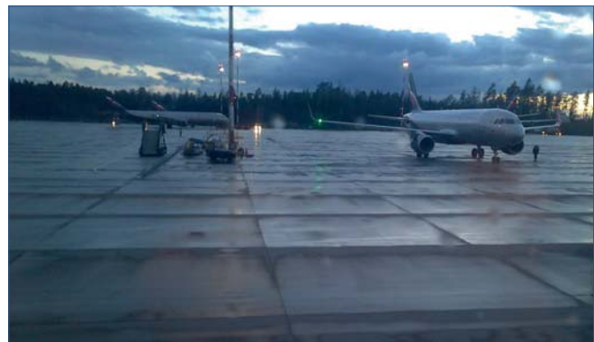
Figura 2. Alabeo negativo de losas, Aeropuerto Sheremetyevo (Moscú, 2015)
