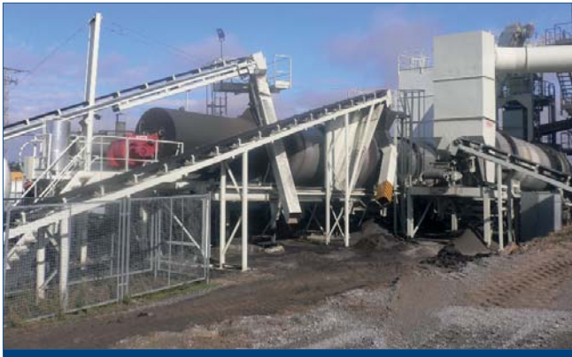
Figura 5. Instalación asfáltica de tipo discontinuo con tambor secador independiente para el material fresado
