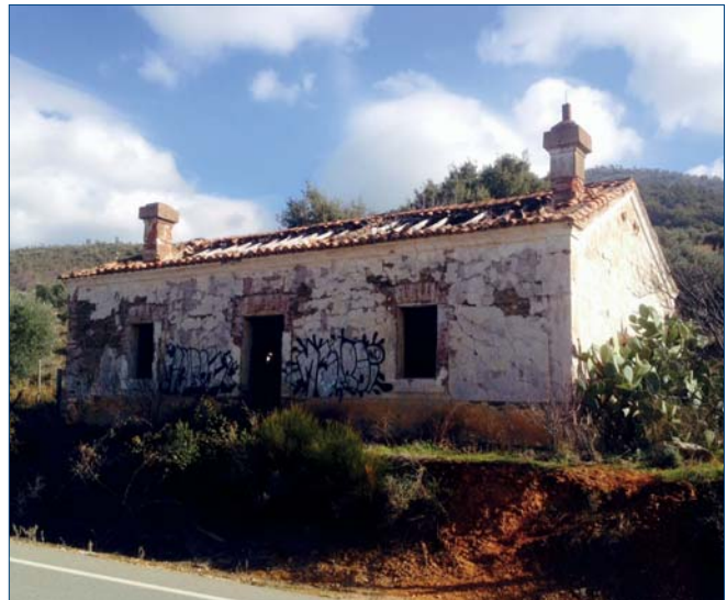
Figura 1. Casilla en ruinas en la antigua CC-713
