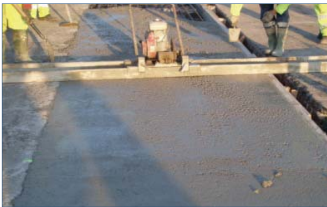
Figuras 7 y 8. Una de las escasas reparaciones del pavimento de hormigón armado
