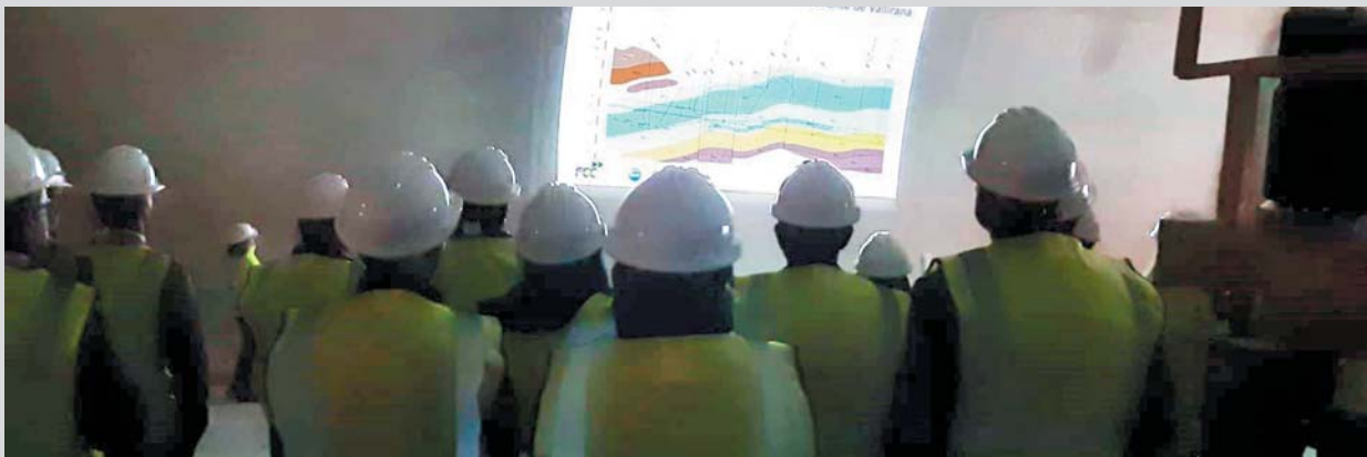
Durante la tarde del día 13 tuvo lugar la visita de los asistentes al Simposio a las obras de los túneles de la Plaza de les Glories, Vallirana en la N-340 y Viladecavalls en la B-40 donde se debatieron aspectos técnicos
