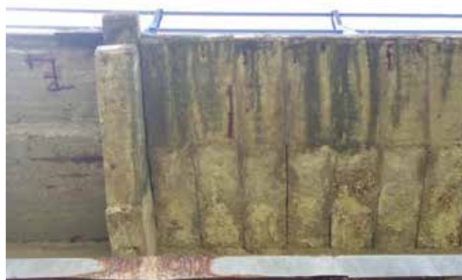
Figura 6. Daños en ensanchamiento de tablero de hormigón armado
