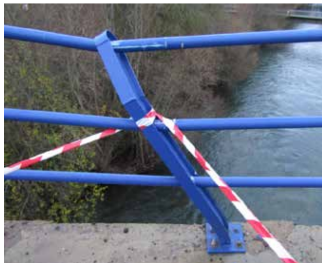
Figura 5. Daños en el pretil-barandilla tras el accidente de mayo de 2018
