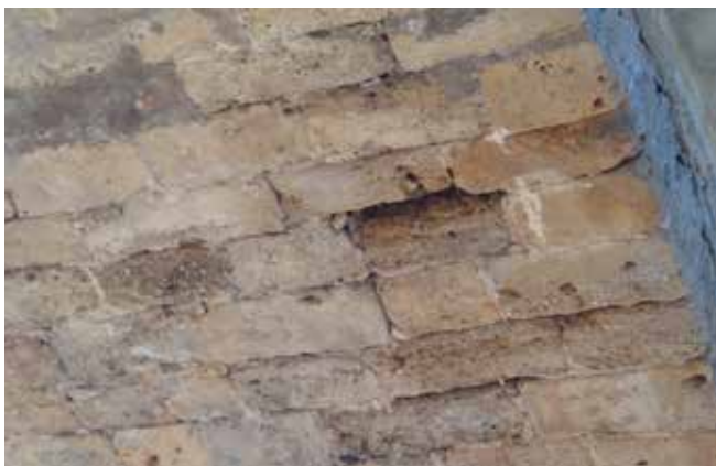
Figura 8. Ejemplo de sillar deteriorado
