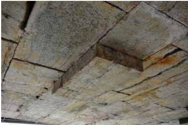
Figura 7. Sillar parcialmente desprendido
