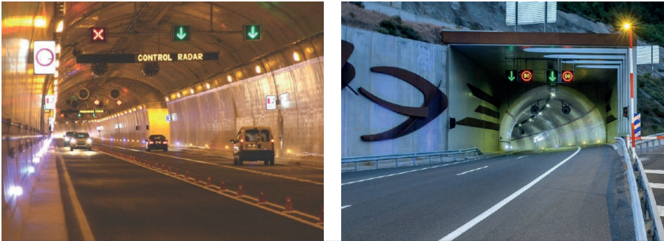
Ilustración 11. Limitación de velocidad, túnel de Caldearenas y control de velocidad túnel de Petralba
