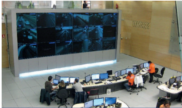
Ilustración 20. Centro de Control. Túneles de Calle 30
