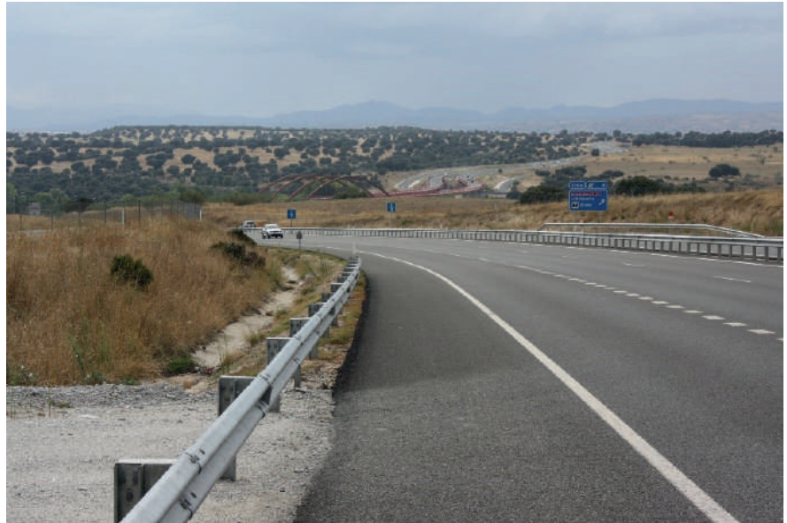
Foto 1. Barrera de seguridad
