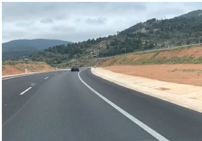
Figura 4. Apartadero exterior sobre cuneta de seguridad
