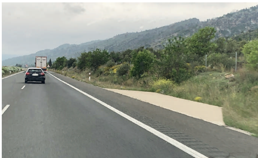
Figura 6. Apartadero exterior reducido
