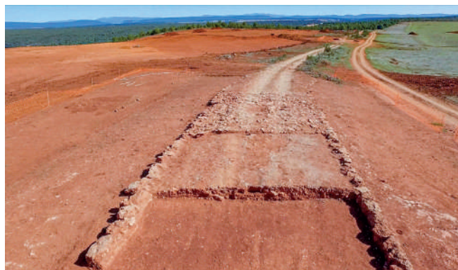
Sección del firme de la calzada romana en su tramo entre Augustobriga, Numancia y Uxama. Isaac Moreno Gallo.
