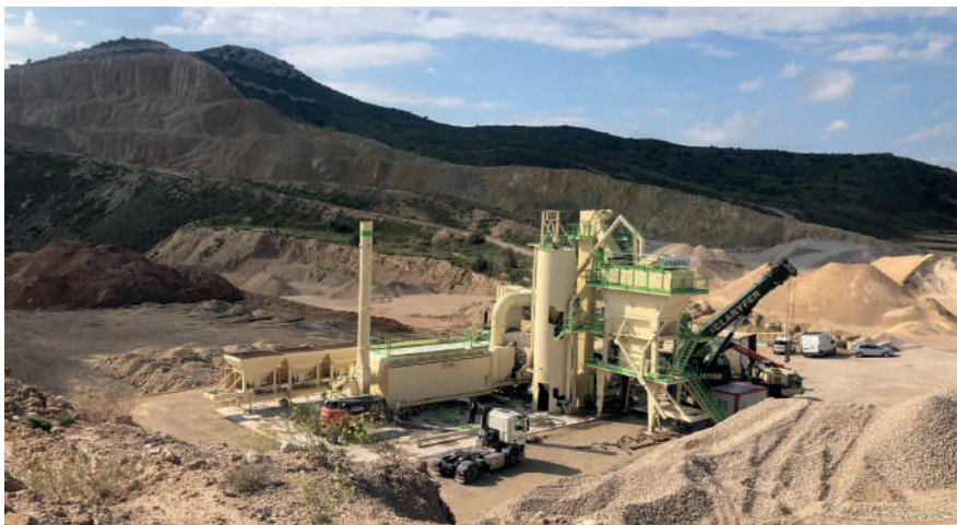
Figura 2. Central de fabricación de mezclas bituminosas en caliente, marca INTRAME, modelo UM-200, instalada en el T.M. de Botorrita (Zaragoza)
