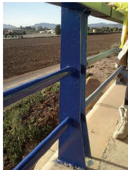
Figura 3. Aplicación de una capa de acabado con ligante base silicona de alta resistencia a intemperie, de espesor mínimo de 50 \mu\text{m} por capa, de color RAL 5002 (azul nuclear)
