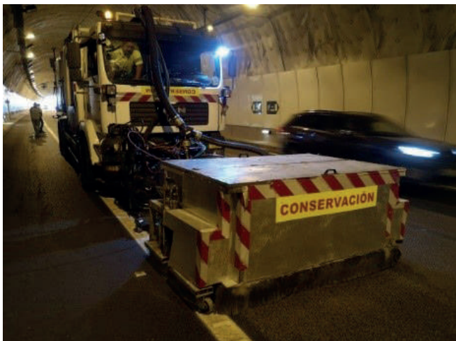
Figura 5. Equipo de sistema hidro-mecánico para la mejora del CRT. (ITOC 12223 a 12224_Mejora del CRT)
