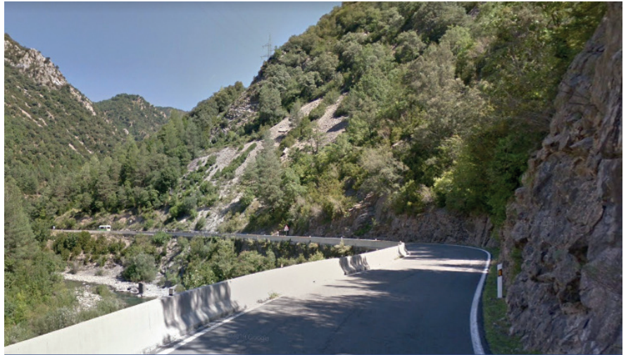
Figura 22. Estado de la carretera previo a la actuación (2015)
