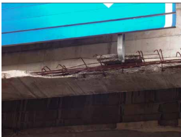
Deterioro producido en tablero de vigas por choque de vehículo.
