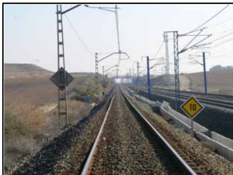
Figura 1: Obsérvese la deformación existente en la vía antes de las actuaciones.
