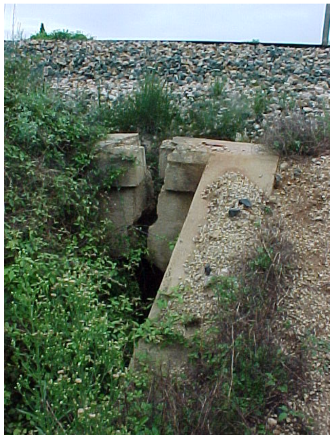
Lado derecho. P.K. 46+400. Tubería de acero corrugado para el drenaje transversal del terraplén. Las boquillas del drenaje son de hormigón y en este caso se encuentra completamente agrietada.
