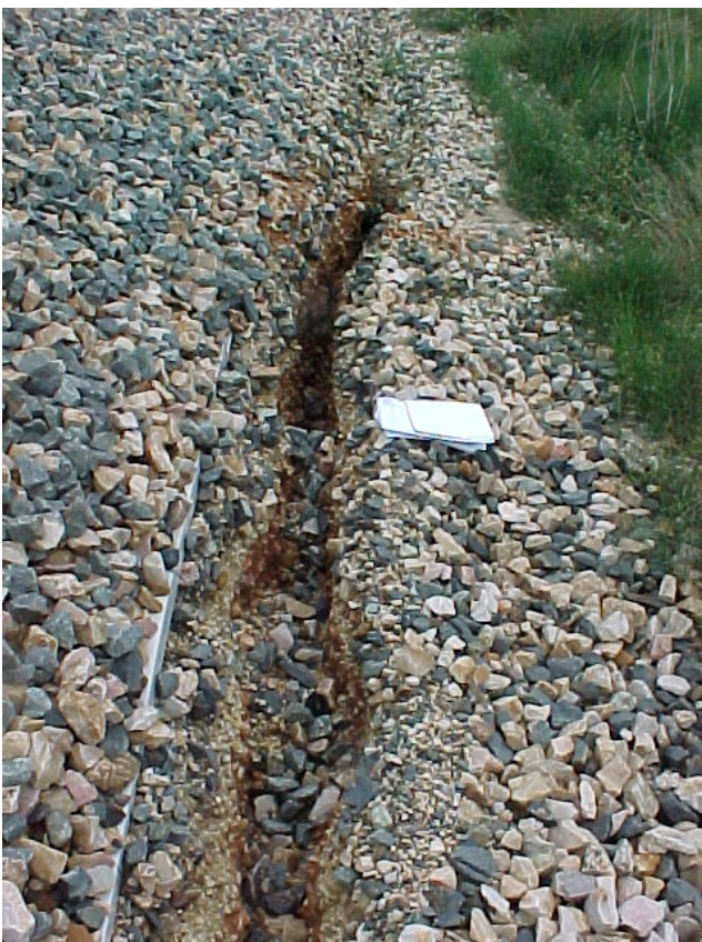
Lado derecho. P.K. 47+100. Grieta importante en la plataforma en su zona de máxima apertura. Tiene una profundidad de 1 m.
