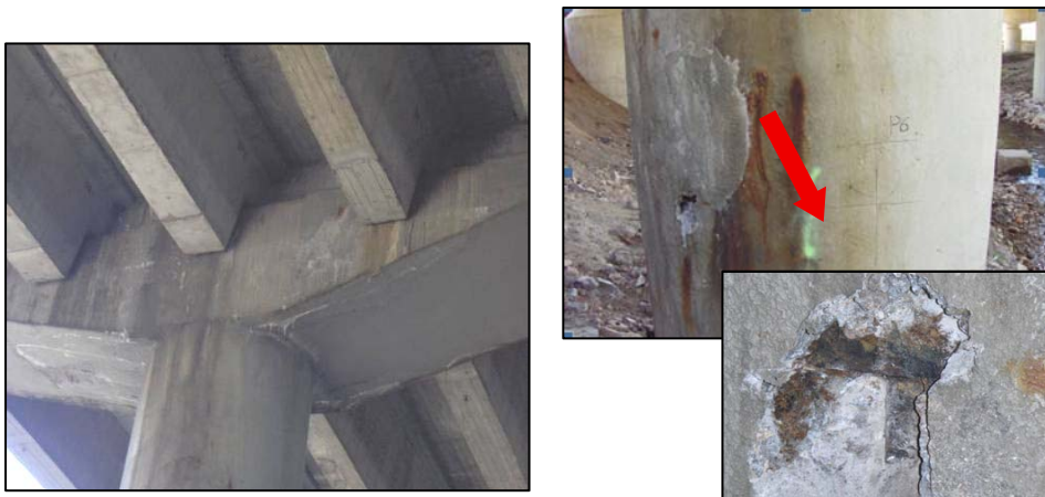
Efectos de la corrosión por cloruros en una pila con sales fundentes
