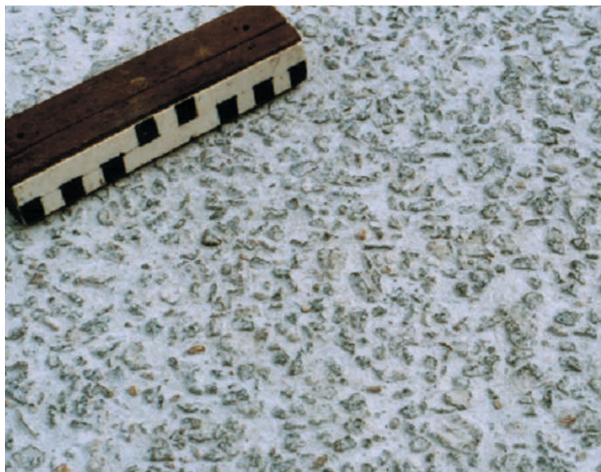
Figura 16. Autopista Bruselas-Ostende: detalle del pavimento denudado.
