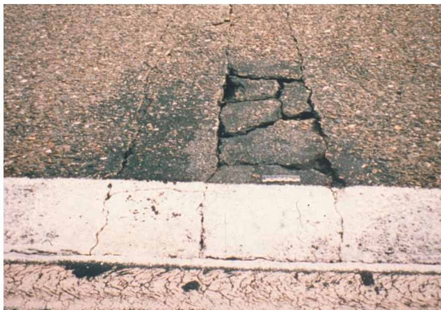
Figura 9. Rotura por punzonamiento.
