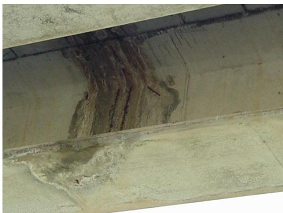
Figura 19. Daños en viga de borde por falta de bajante en desagüe, escurriendo el agua por el alma de la viga, produciendo daños por corrosión.
