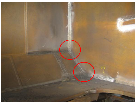
Figura 39. Cruce de 3 cordones de soldadura sin ojales, lo que puede acabar produciendo problemas de fatiga en la unión.
