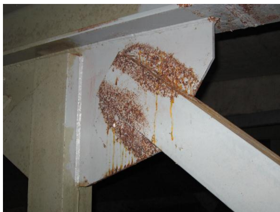
Figura 54. Formación de óxido en elementos metálicos en las inmediaciones de las soldaduras por la diferencia de potencial eléctrico existente entre los materiales.
