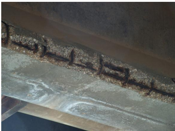
Figura 25. Detalle de corrosión por carbonatación en ángulo de viga doble "T".
