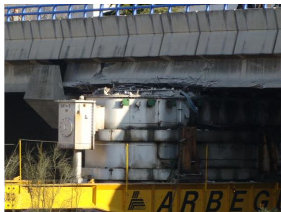
Figura 57. Rotura completa de viga por vehículo circulando con exceso de gálibo.
