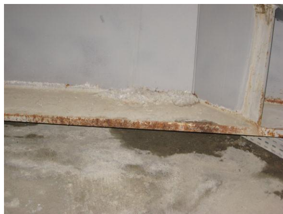
Figura 47. Oxidación de platabanda metálica por circulación de agua y acumulación de suciedad.
