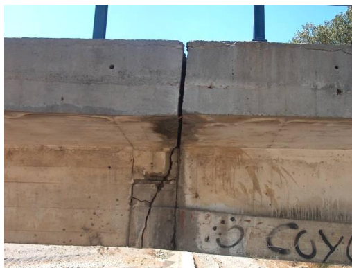
Figura 31. Degradación y rotura del apoyo a media madera por la presencia frecuente de agua, acentuado por la estricta entrega de apenas 30 cm.
