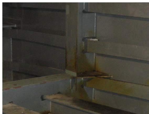
Figura 43. Detalle de interior de puente mixto con acumulación de suciedad y humedad, con la consiguiente degradación de la pintura de protección.
