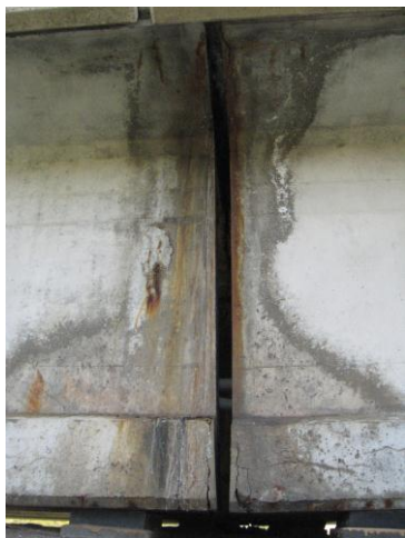
Figura 21. Detalle de junta entre vigas con importantes daños por la circulación de agua a través de la junta de dilatación.
