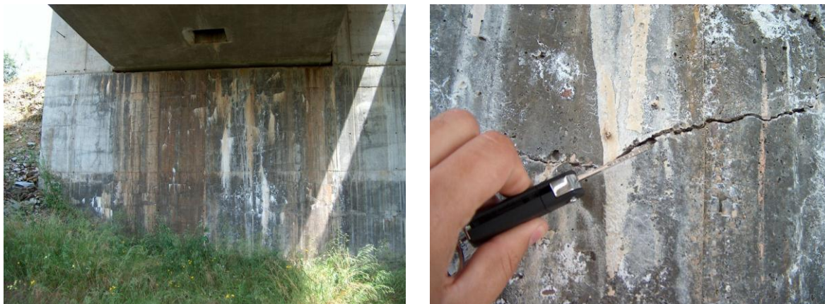
Figuras 27 y 28. Vista general y detalle de estribo afectado por un ataque por sulfatos.
