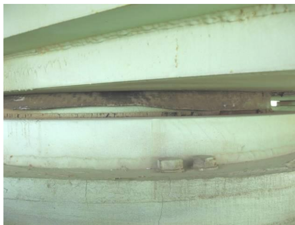
Figura 68. Rebosamiento de la lámina de teflón del apoyo tipo POT, por posible flexión del pistón de confinamiento.
