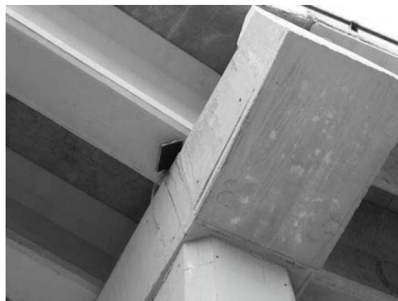
Figura 15. Aparato de apoyo de neopreno zunchado a punto de caerse del dintel de pila, expulsado por la ausencia de cuña de nivelación.
