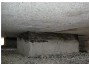
Figura 16. Apoyo de neopreno zunchado con cuña vulcanizada, colocado al revés. Rotura de apoyo por zona de cuña.
