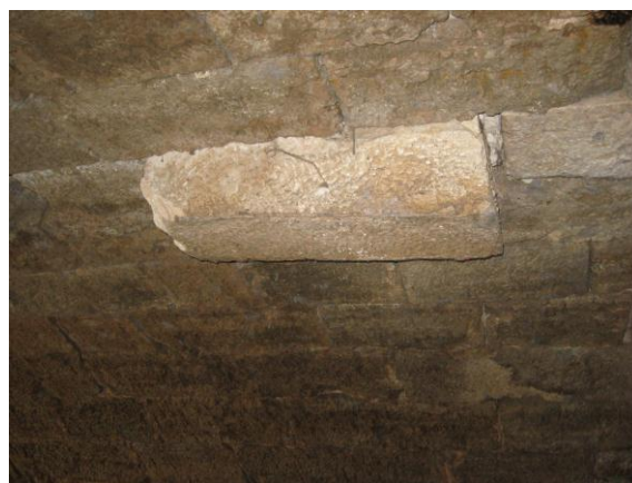
Figura 13. Sillar descolgado por lavado de llagas.
