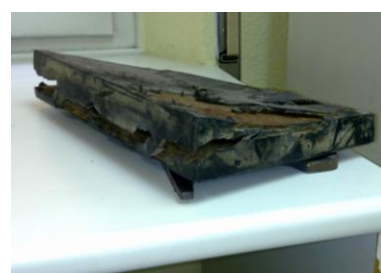
Figura 18. Rotura de aparato de apoyo de neopreno zunchado con cuña metálica por esfuerzos tangenciales.
