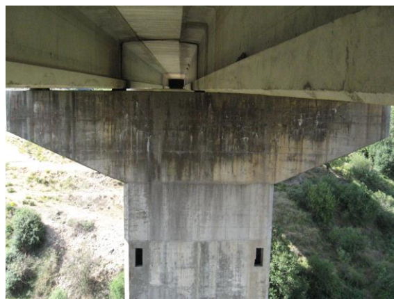
Figura 20. Cabeza de pila de puente de vigas con daños significativos por circulación de agua a través de la junta de dilatación.
