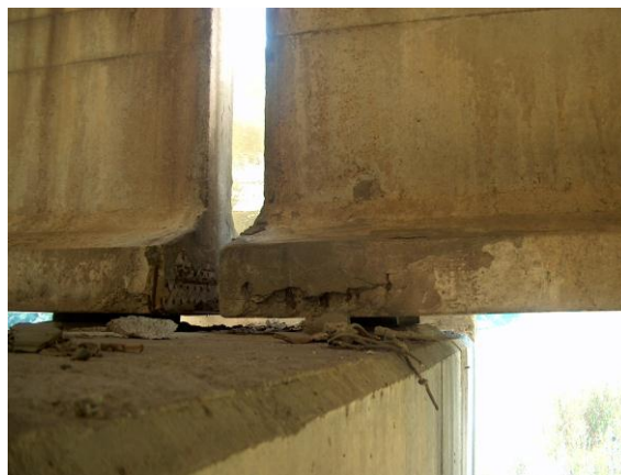
Figura 22. Degradación del refrentado de vigas y fisuración y lajación del hormigón, con corrosión de las armaduras.
