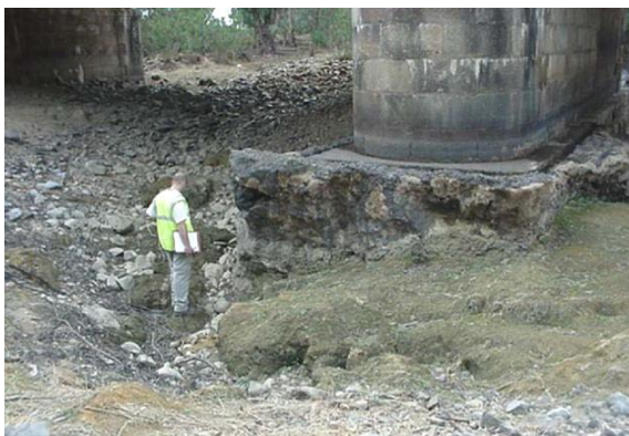
Figura 2. Fosa de socavación en un puente arco de fábrica.
