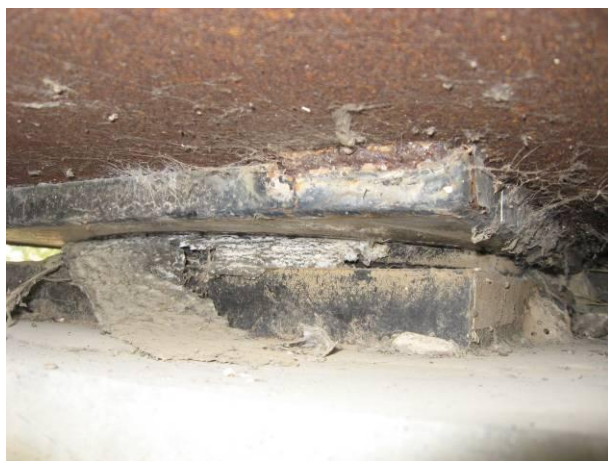
Figura 67. Rasgado y expulsión de la lámina de teflón, por falta de paralelismo entre las caras de apoyo del POT.
