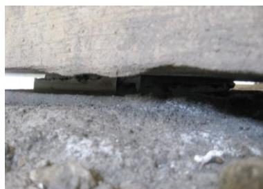
Figura 17. Rotura de aparato de apoyo de neopreno zunchado por deficiente dimensionamiento para los movimientos impuestos.
