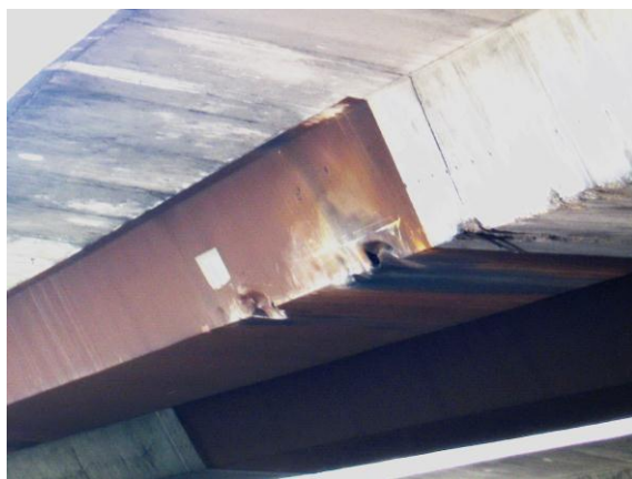
Figura 56. Daños en cajón metálico por impacto de vehículos con exceso de gálibo. Se puede observar en la zona de losa, diferentes golpes sin apenas repercusión estructural.
