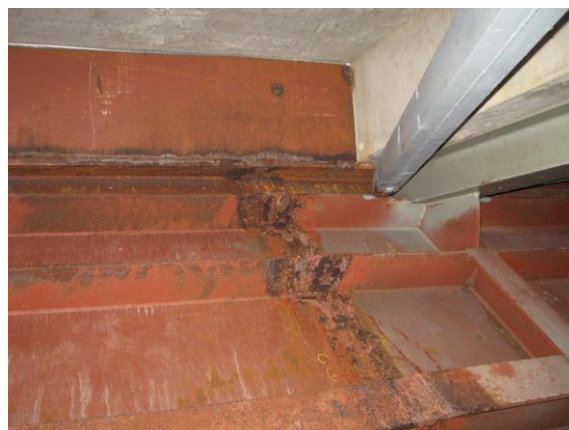
Figura 55. Concentración de óxido en las proximidades de la unión con soldadura debido a la diferente naturaleza del electrodo y el acero.
