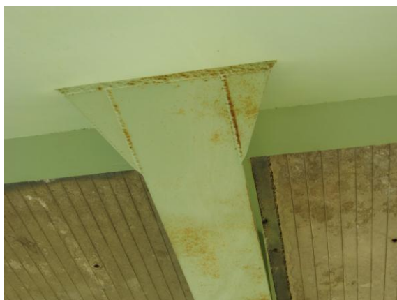
Figura 46. Comienzo de degradación de pintura de protección en elemento metálico. Obsérvese que comienza y se acentúa en la zona de las soldaduras.
