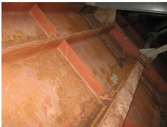
Figura 42. Alma lateral puente mixto con sección cajón. Los rigidizadores longitudinales de alma provocan la acumulación de suciedad, agua y humedad, provocando el progresivo deterioro de sus inmediaciones.
