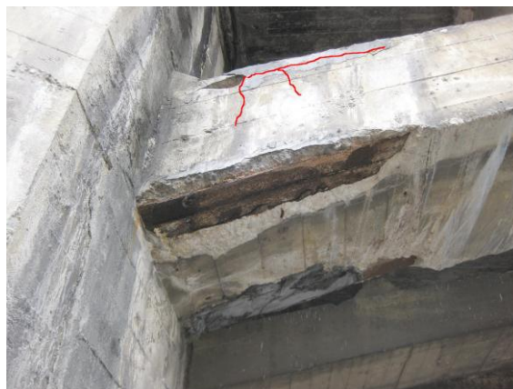
Figura 26. Oxidación de perfiles metálicos propio de puentes de la colección de E. Ribera.
