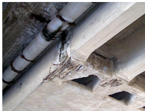
Figura 32. Degradación del apoyo a media madera por circulación de agua a través de la junta de dilatación, produciendo la oxidación de las armaduras.
