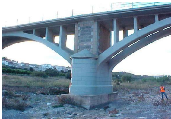
Figura 3. Cimentación de pila afectada por la erosión general y local, en un puente arco de hormigón.
