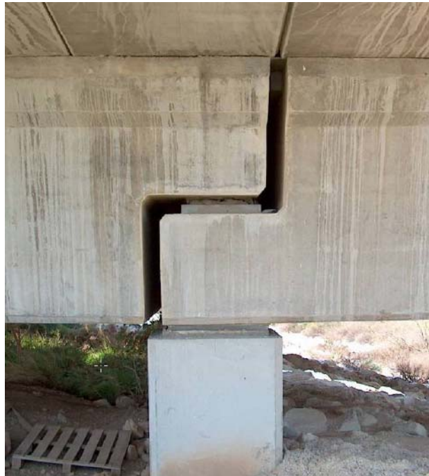
Figura 11.- Apoyo poco accesible para su sustitución
