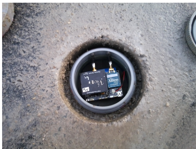
Figura 9. Waspote con sensor de parking enterrado en el asfalto de una zona de aparcamiento
