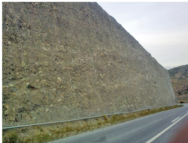
Figura 7. El uso de tensiómetros en las vallas de contención permite conocer también el estado de los mismos.
