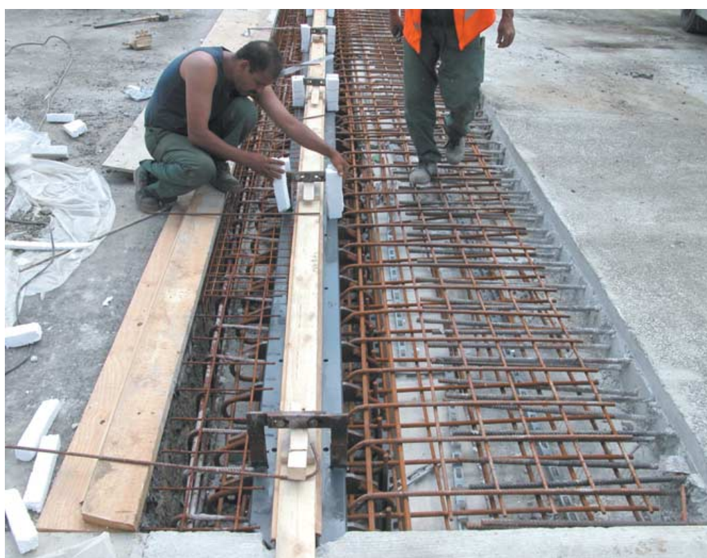
Figura 25 a y b: Circunvalación de Amberes: anclaje con junta de dilatación.
