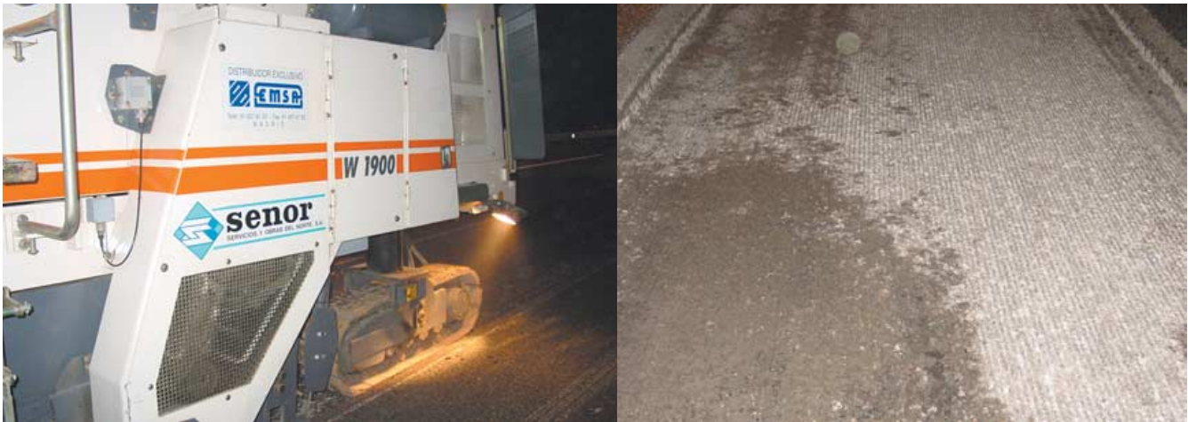
Foto 12. Fresado y aspecto del carril una vez terminada la operación. Se observan las grietas longitudinales y la humedad en el firme procedente de la infiltración de las capas subyacentes.
