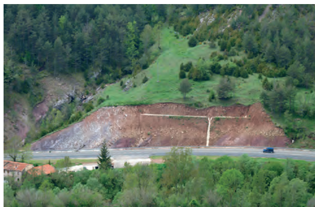
Figura 19. Estado inicial talud
