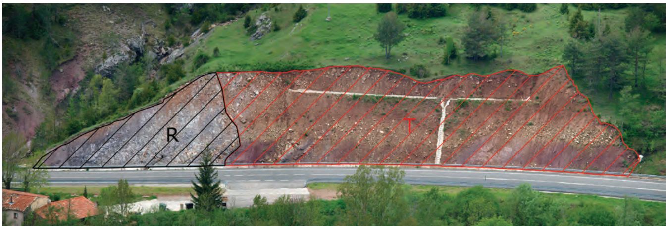
Figura 8. División del talud por consistencia. R: área roca y T: área tierras
