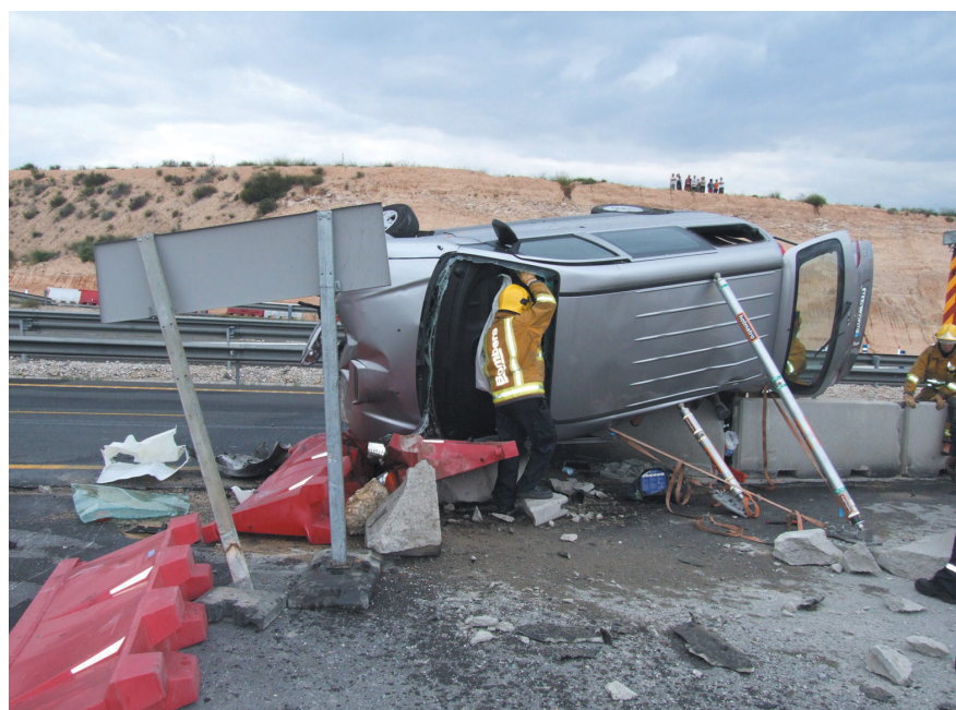
Disponer barreras de plástico y agua para obras seguidas de barrera de hormigón, es una combinación agresiva que está muy lejos de proteger.
