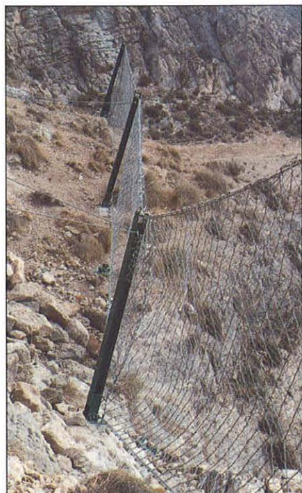
Ejemplo de defensa pasiva dispuesta en el tramo.
