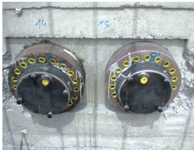
Acopladores del pretensado
