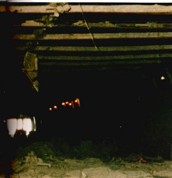
Estado del túnel II tras el incendio
