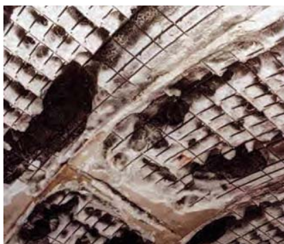
Figura 8. Daños por "spalling" en las dovelas del túnel de la Mancha después del incendio de 1996
