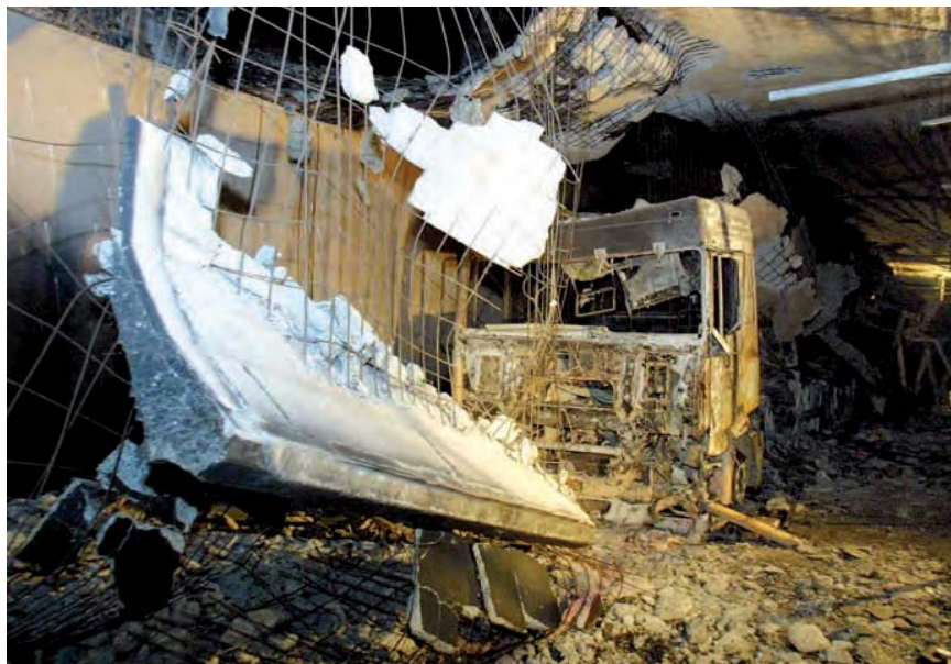
Figura 5. Elementos de la infraestructura del túnel de San Gotardo caídos después del incendio de 2001
