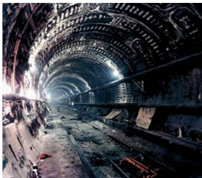
Figura 7. Daños en las dovelas del túnel de La Mancha después del incendio de 1996
