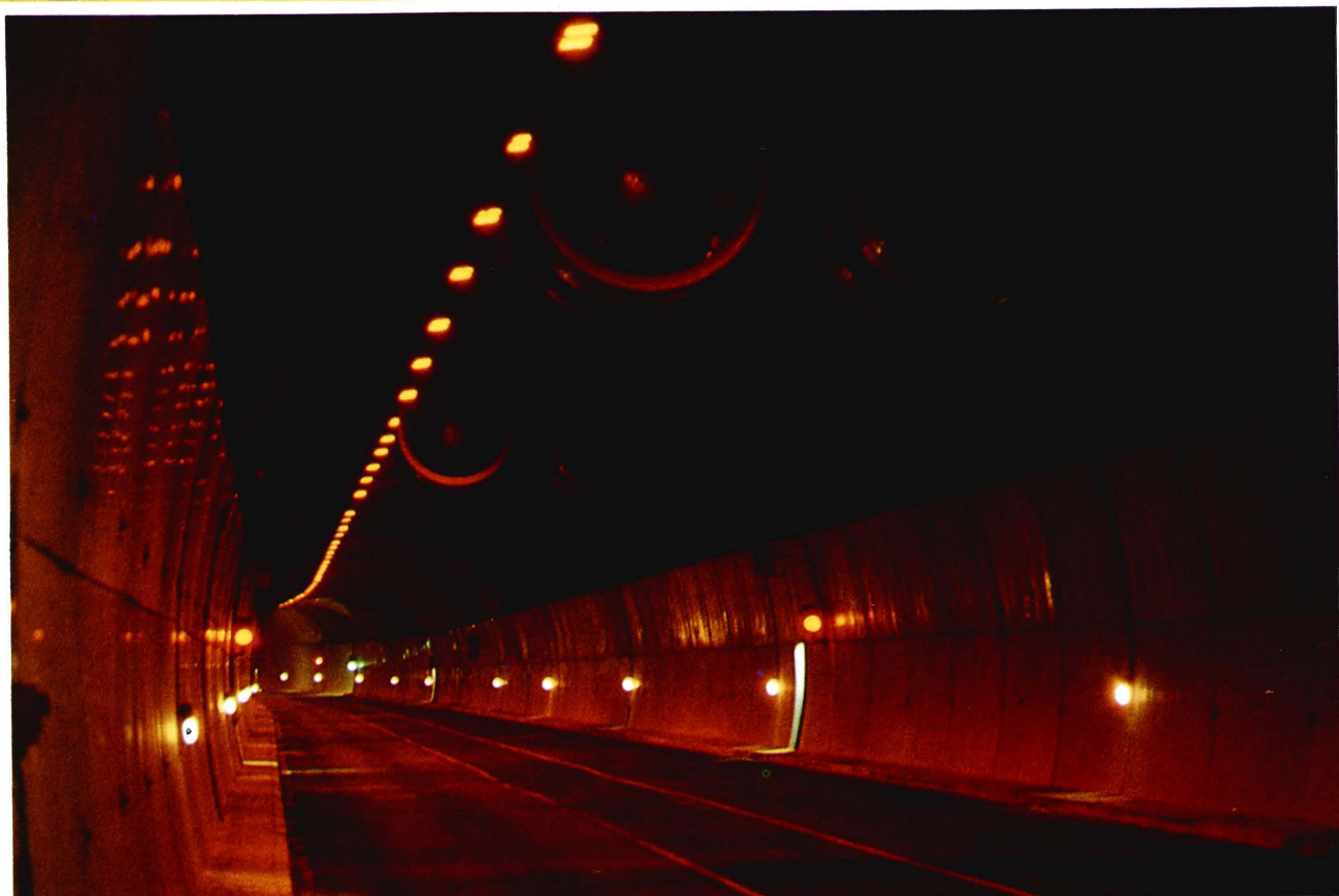
Foto 2: Interior del túnel del Cadí. Se observan los "jets" de la ventilación longitudinal
