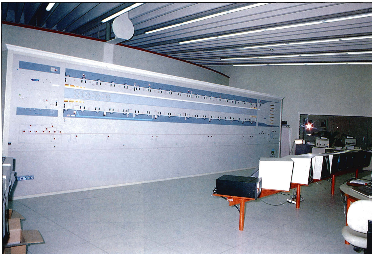
Foto 4: Sala de control del túnel
