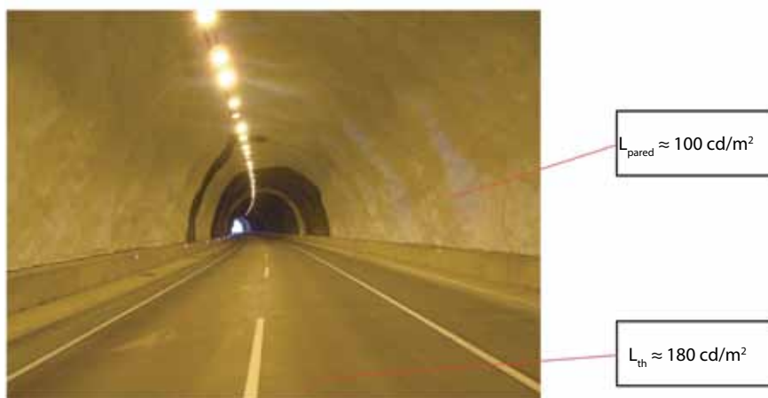
Figura 5. Mediciones luminotécnicas en la zona umbral de la boca de entrada Norte del túnel E
