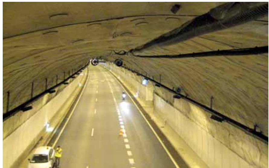
Foto 6. Cable de detección lineal de incendios
