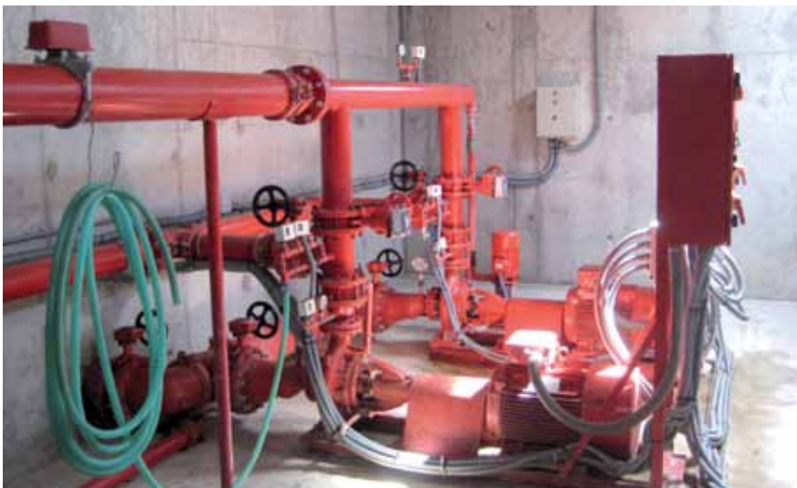
Foto 5. Grupo de bombeo
