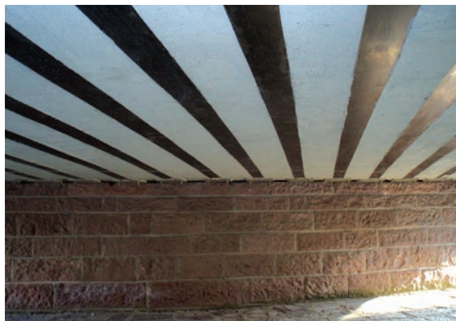
Figura 2. Ejemplo de refuerzo con materiales compuestos.
