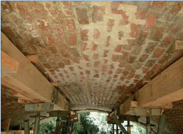
Llagueado de la fábrica de ladrillo
