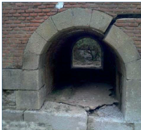
Detalle de arcos dañados
