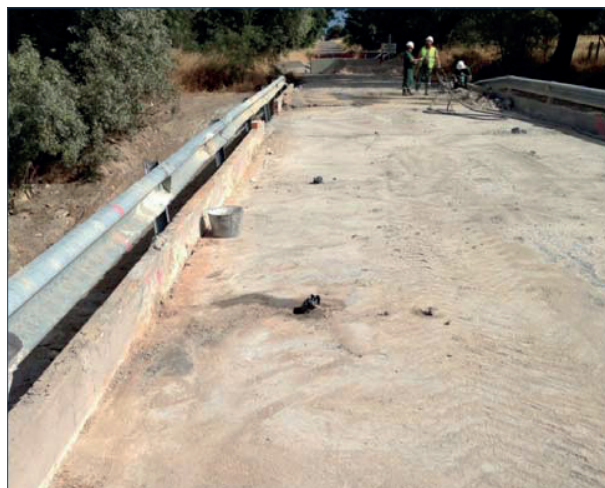
Muros laterales para la contención del detritus
