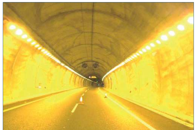
Figura 6. Iluminación de refuerzo de un túnel de carretera
