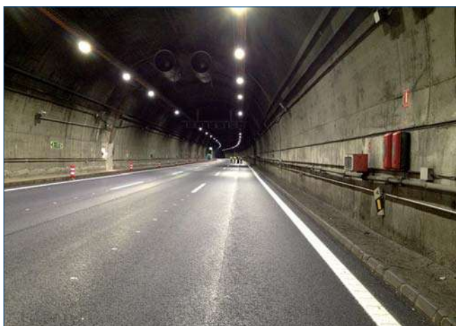
Iluminación Led al 100 % de la potencia
