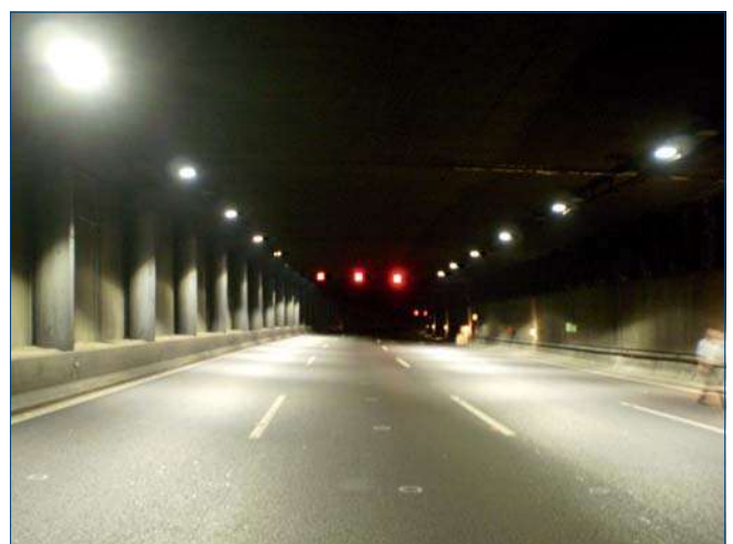
Alumbrado con Led en el túnel de calzadas superpuestas de la M40
