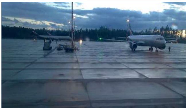
Figura 2. Alabeo negativo de losas, Aeropuerto Sheremetyevo (Moscú, 2015)
