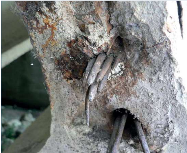
Figura 19. Alambres rotos hacia algún tiempo en sección de viga 1 (lado izquierdo), vista hacia E-1
