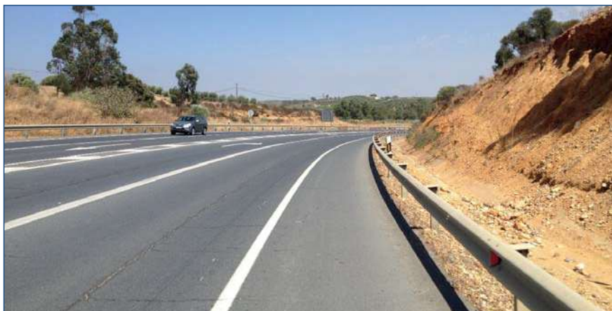
Cuneta y talud de desmonte protegidos con barrera de seguridad
