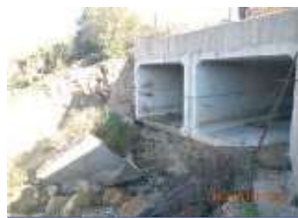
Figura 6. Rotura aletas en marco prefabricado
