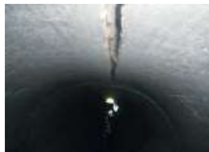
Figura 5. Tubo de hormigón con rotura longitudinal en generatriz superior e inferior
