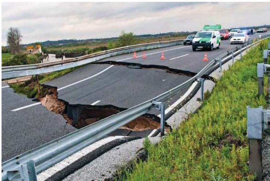
Figura 1. Autovía colapsada por fallo estructural de la ODT.
