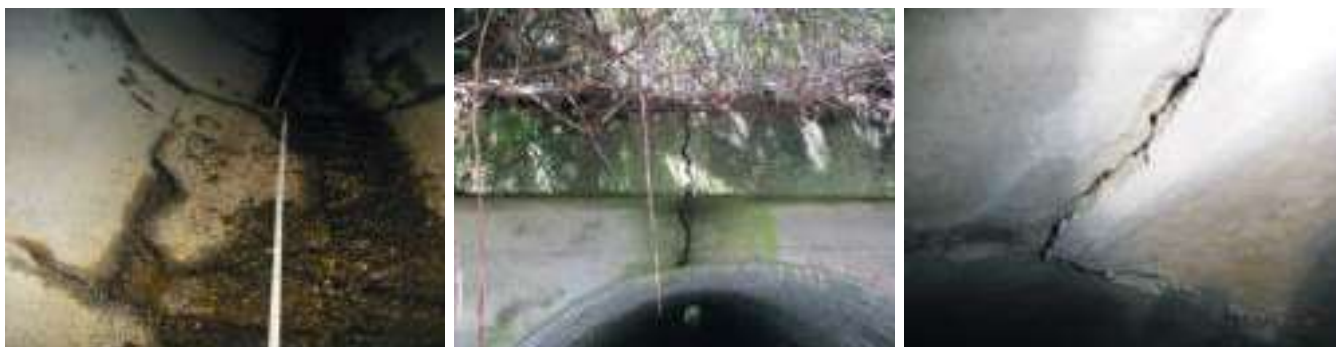
Figura 3. Tubos dañados por fisuración
