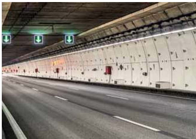
Figura 4. Estado pavimento hidrodesebastado
