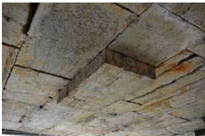
Figura 7. Sillar parcialmente desprendido
