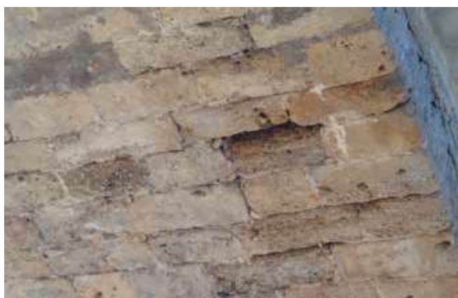
Figura 8. Ejemplo de sillar deteriorado
