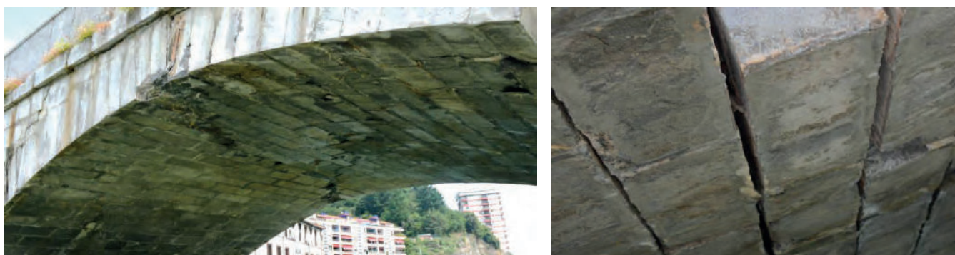
Figura 4. Izquierda, rotura en compresión de intradós de B-3. Derecha, apertura de juntas en intradós de B-2
