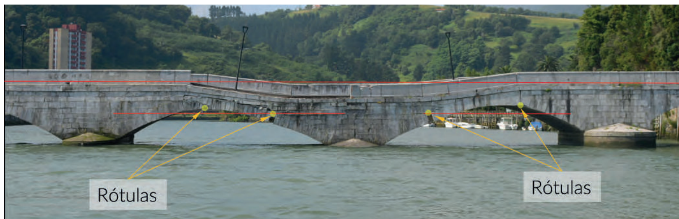
Figura 3. Posición de las rótulas en las bóvedas 2 (izquierda) y 3 (derecha) desde aguas abajo. Se han trazado las líneas presuntamente horizontales de la imposta (roja superior) y las paralelas a ésta por la rótula más baja
