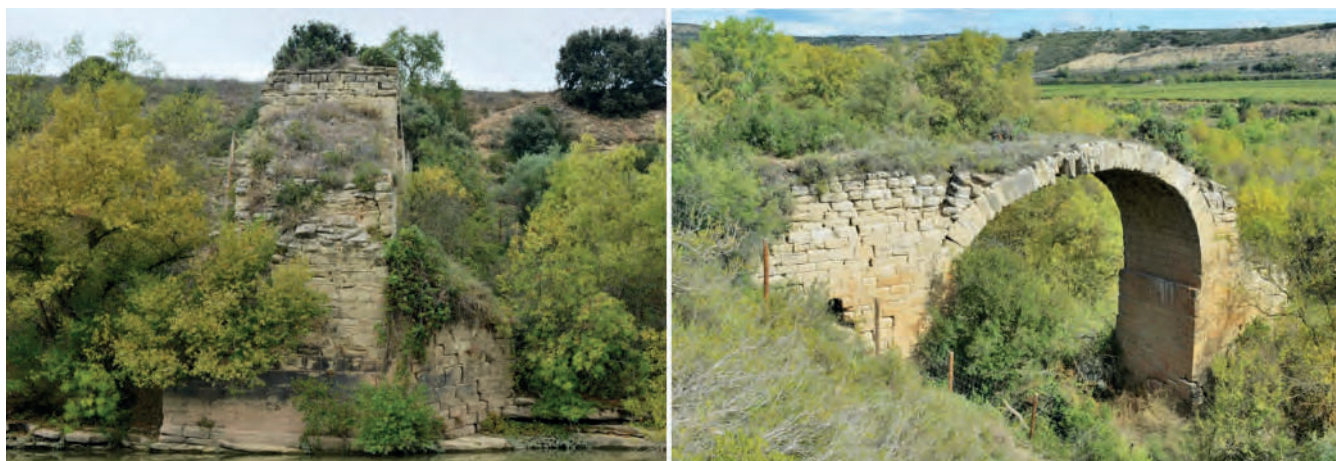
Figura 15. Puente Mantible (Logroño). Fotos de este equipo, cuando emitió un informe motu proprio remitido al Ayuntamiento para advertir del riesgo de colapso (noviembre de 2019). El texto recibió el informe favorable de la Comisión de Monumentos de la Real Academia de Bellas Artes de San Fernando y se convocó concurso para la restauración
