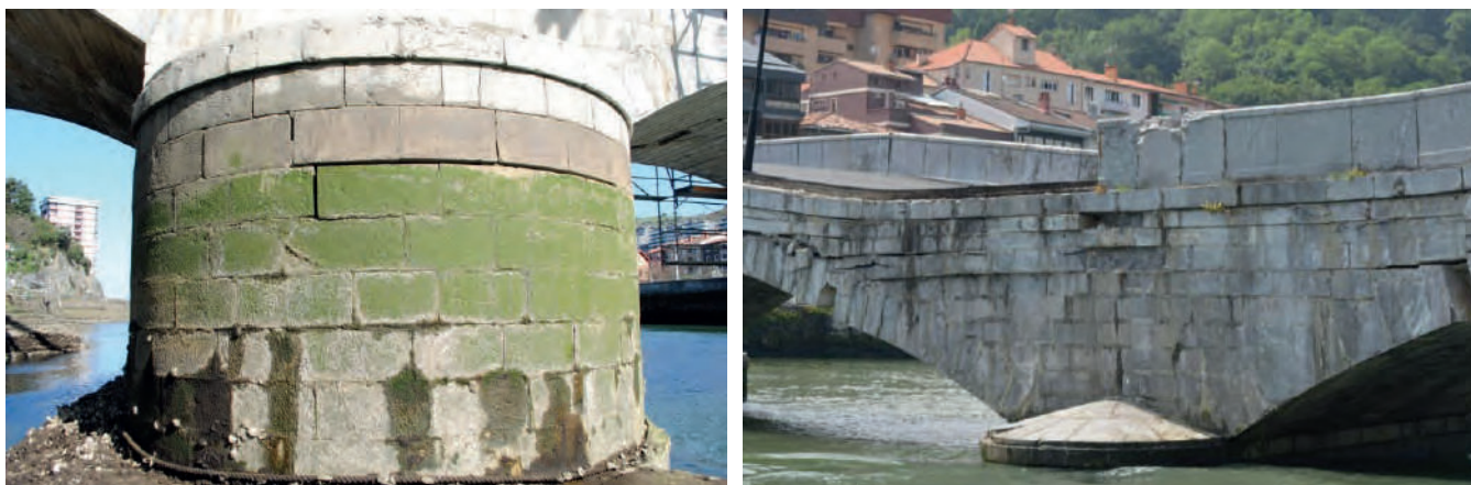
Figura 5. Despegue de sillares en tajamar de aguas arriba de P-3 y piezas rotas a compresión en tímpano sobre pila 2
