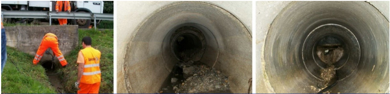
Figura 1. Tareas de inspección y mantenimiento correctivo en un colector de un tramo de carretera de Bizkaia, tras un episodio de lluvias. La imagen derecha muestra el estado de bloqueo del colector
