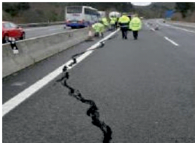
Figura 5. Problemas de seguridad vial por la caída de piedras en la carretera N-621 tras las intensas lluvias
