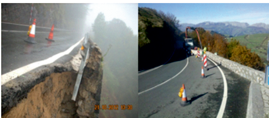
Figura 15. Hundimiento de la plataforma de la carretera N-629 causado por las fuertes lluvias y señalización provisional
