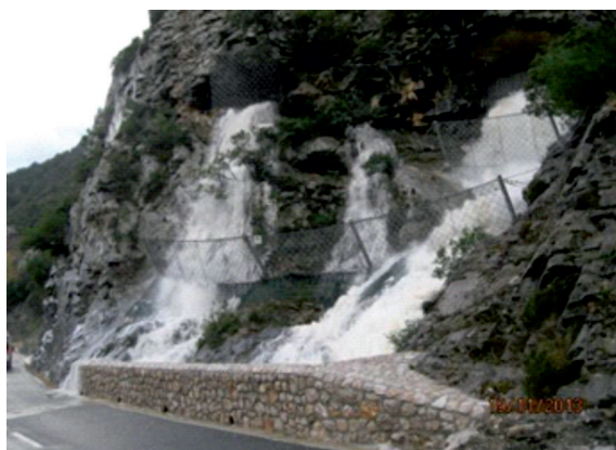
Figura 17. Problemas de seguridad por la caída de piedras en la carretera N-621 tras intensas lluvias. Situación del PK 158,140 margen izquierdo producido por las fuertes lluvias en la ladera rocosa (aguas arriba) donde se realizó la actuación.
