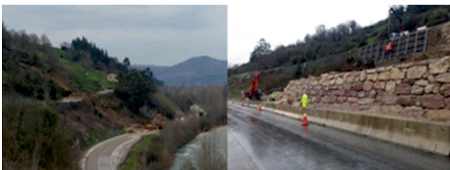
Figura 16. Deslizamiento de tierra provocado por las fuertes lluvias, causando el corte total de la carretera N-623 y N-623a en la tarde del 10 de marzo de 2016. PK 117+300 margen izquierdo
