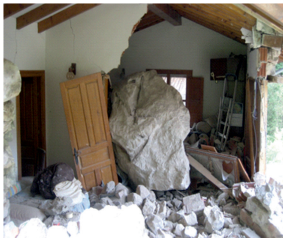
Figura 2. Situación producida tras las intensas lluvias con caída de piedras.
