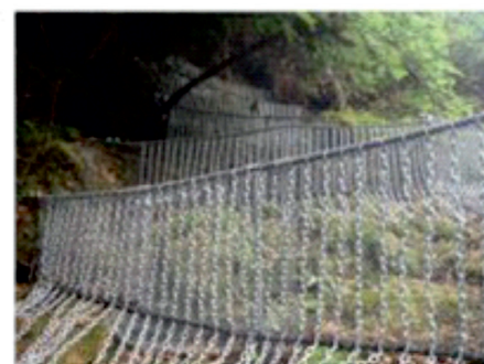
Figura 8. Situación del PK 169,050 MI producida por lluvias intensas y distribución de protecciones en canales 2, 3 y 4
