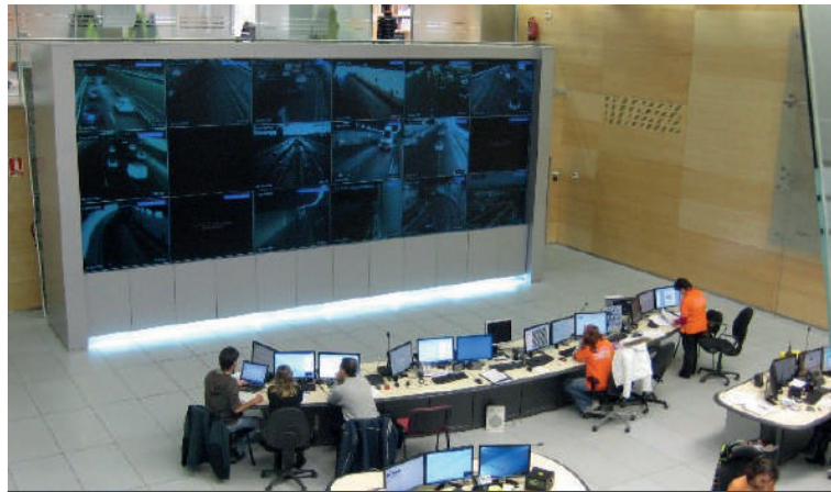
Ilustración 20. Centro de Control. Túneles de Calle 30
