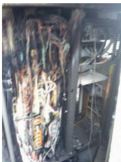
Ilustración 18: Situación de riesgo por incendio en cuadro eléctrico de mando
