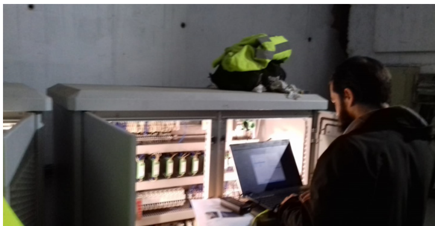
Figura 19. Revisión control sistema amortiguamiento dinámico. IMESAPI 2.021
