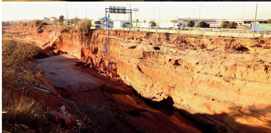
Erosión del lecho del Barranco del Poyo, socavación del talud de separación entre la rambla y la autovía, y generación de un acantilado vertical de unos 15 metros de altura a escasa distancia de la plataforma de los ramales de enlace del p.k. 338 de la autovía A-3 con la carretera CV-374.
