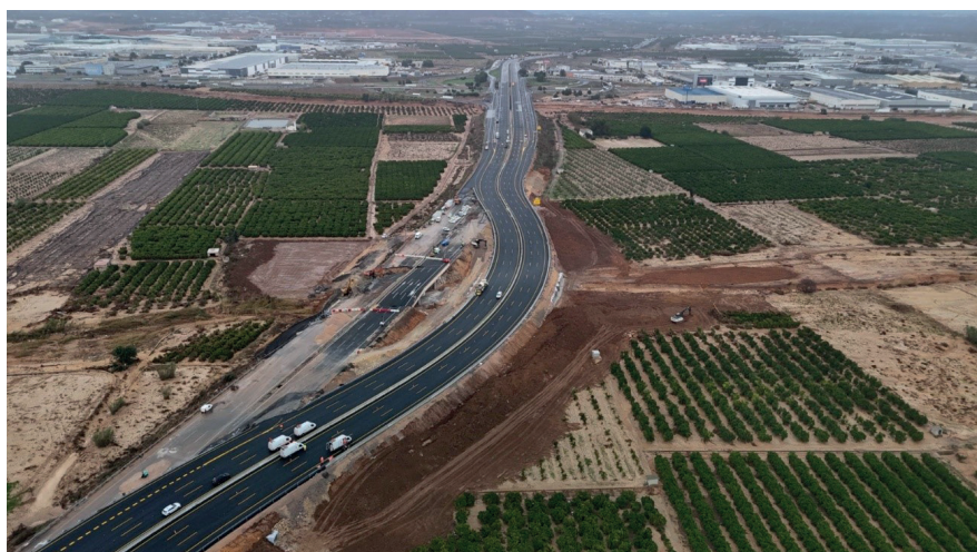
Desvío provisional en la autovía A-7 para salvar las estructuras colapsadas sobre el barranco del Gallego del Poyo en Quart de Poblet (p.k. 336+850)
