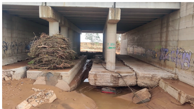
Descalce en la carretera CV-374 pontón sobre el barranco dels Oms en Vilamarxant
