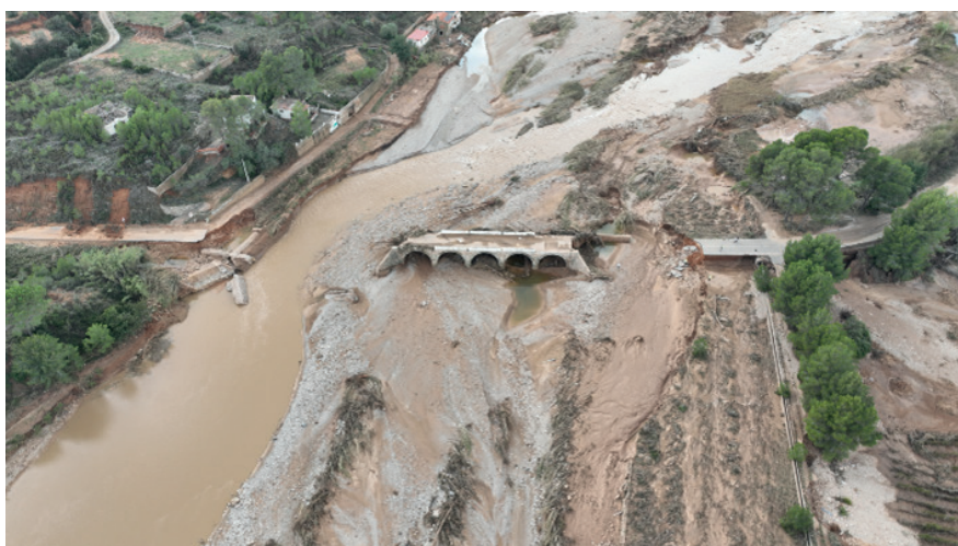
Afección a la carretera CV-422 pontón sobre el río Magro en Turís
