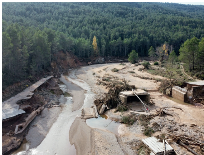
Afección a la carretera CV-429 puente sobre río Mijares en Yátova
