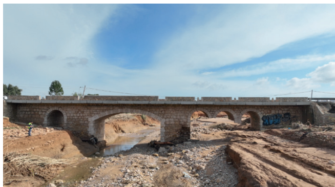
Daños en el puente de la carretera CV-416 sobre el barranco de Fuente-cica en Godelleta
