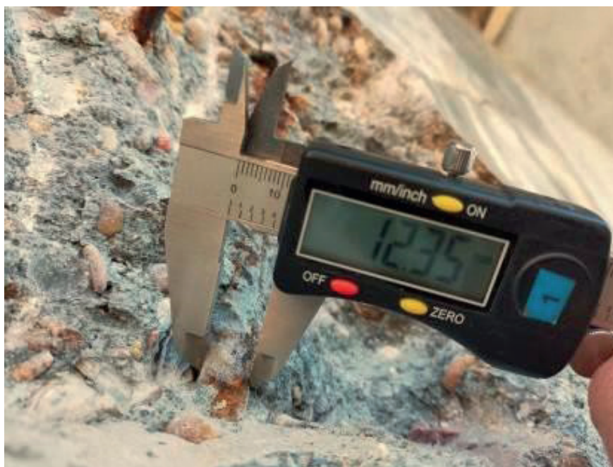
Figura 7. Medida del diámetro de una armadura vista Ø12 en el apoyo a media madera del vano 2, lado P.I. Torrehierro
