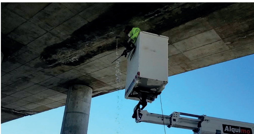
Figura 10. Salida de agua del interior de un aligeramiento tras perforar la clave inferior de la losa de hormigón
