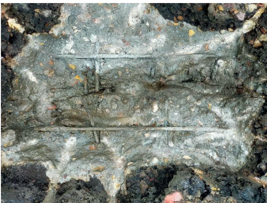
Figura 9. Detalle de las grietas longitudinales en cara superior del vano 1 y armaduras pasivas rotas
