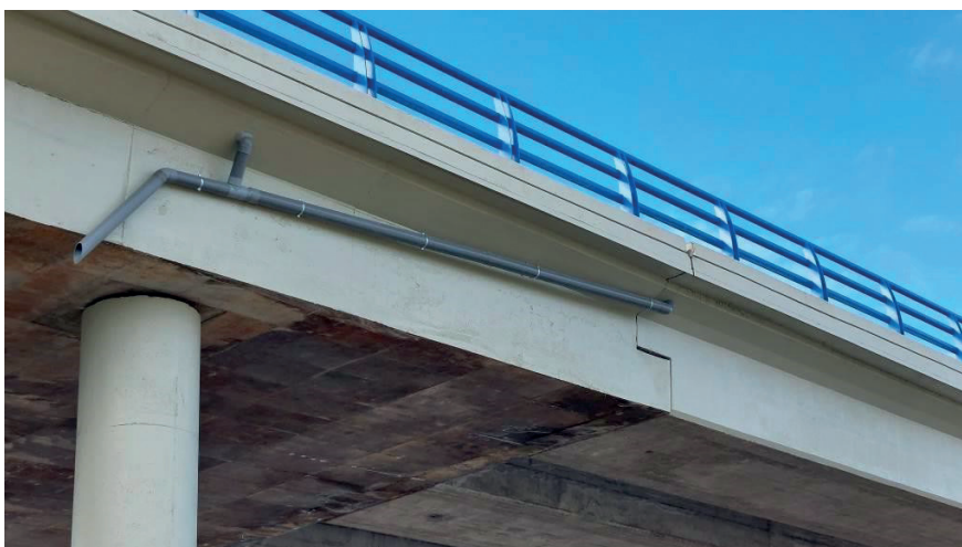
Figura 17. Salida del agua desde los sumideros
