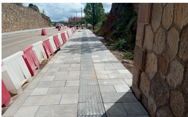
Figura 16. Pavimento en Carretera de Madrid
